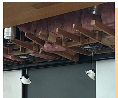
Daños en el techo por el envejecimiento del edificio
